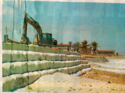
Empresário responsável pela estrutura de barreira já está fazendo o trabalho de recuperação da área dentro do contrato que previa manutenção por cinco anos. Já a Prefeitura planeja mais recursos para ampliar o "Bag Wall". FOTO: NATHAN RODRIGUES
